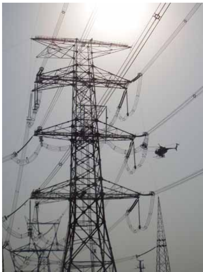
Isolator-rensning på Gochang Power Testing Center
